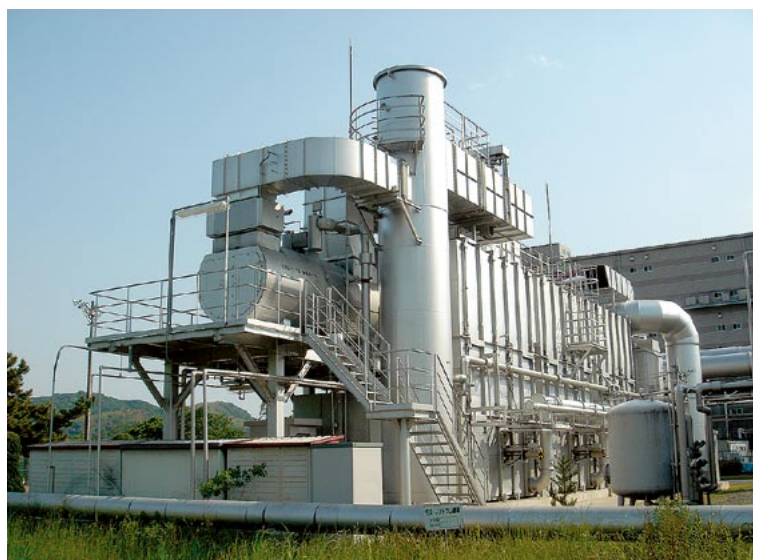
Thermal VOC incinerator at Hitachi Maxell
